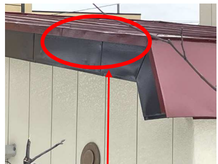
屋根材つなぎ目箇所へこみ有
