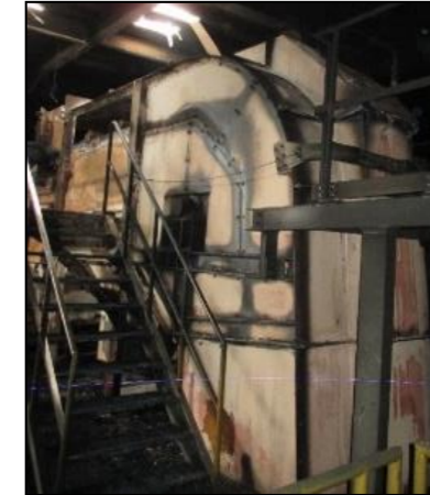
④破碎物コンベヤ（選別室6階側）
