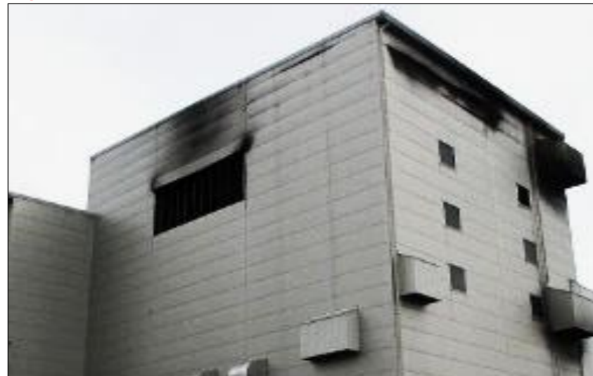
①破碎選別処理施設（外観）
