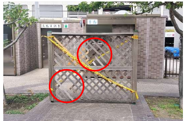
(○箇所 衝立破損被害箇所)
