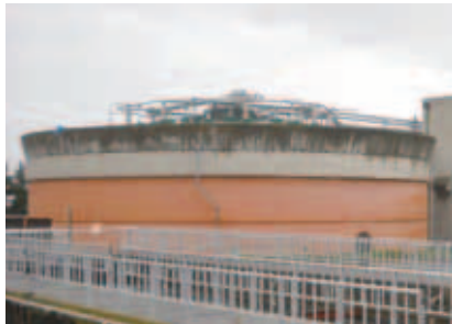
〈内部の改築機械工事が行われる八重田浄化センターNo.1消化タンク〉
