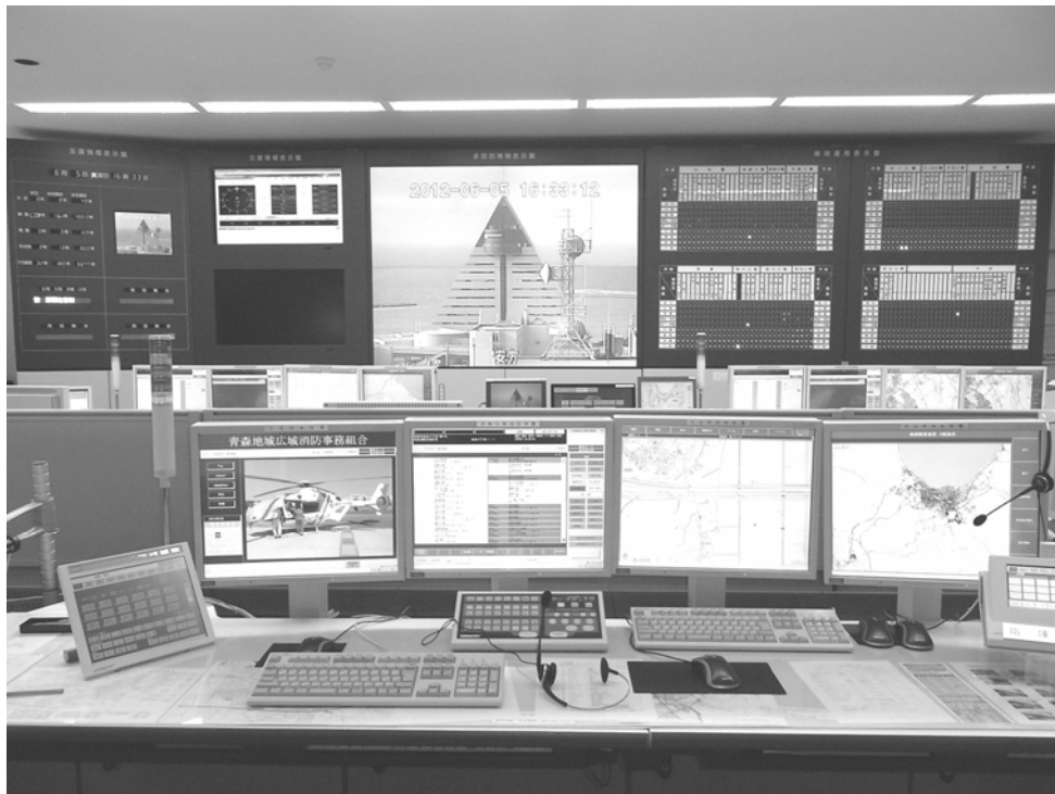
高機能消防指令システム
