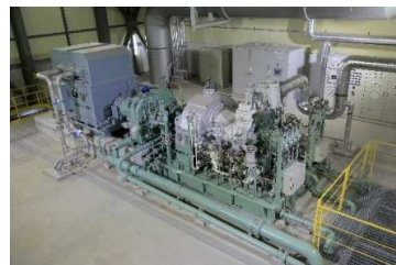
蒸気タービン発電機
