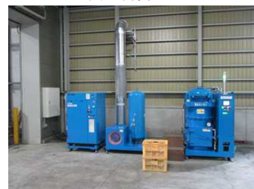
スプレー缶類破碎処理装置
