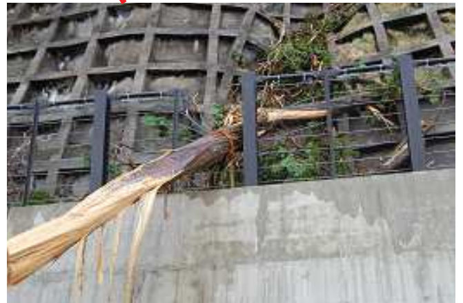
※暴風による倒木被害写真
