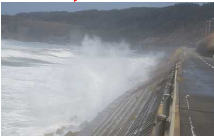
※高波による交通障害写真
