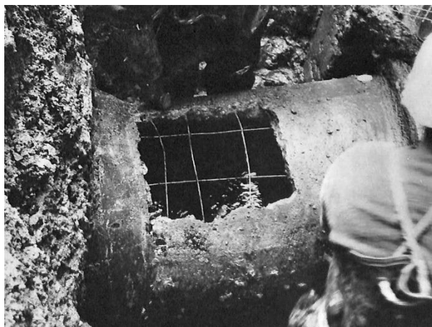
十勝沖地震 ※ による導水管 ※ の破損
