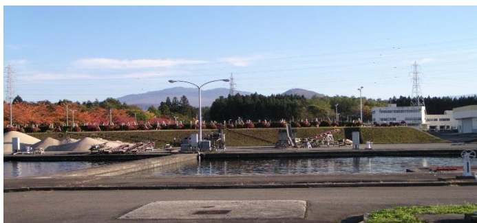
北系ろ過池（左端2号池、中央3号池）
