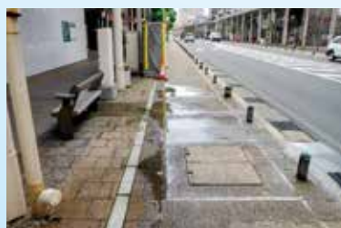
夏期漏水のイメージ写真
