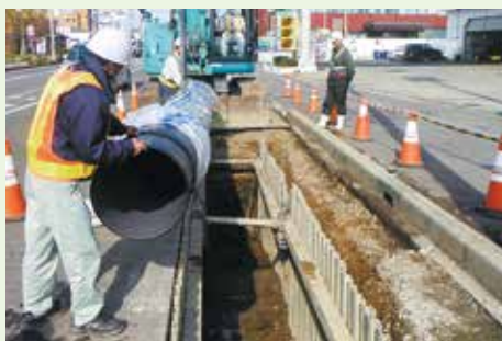
国道103号に布設している ダクタイル鋳鉄管（耐震管）
