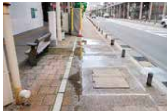
夏期漏水のイメージ写真
